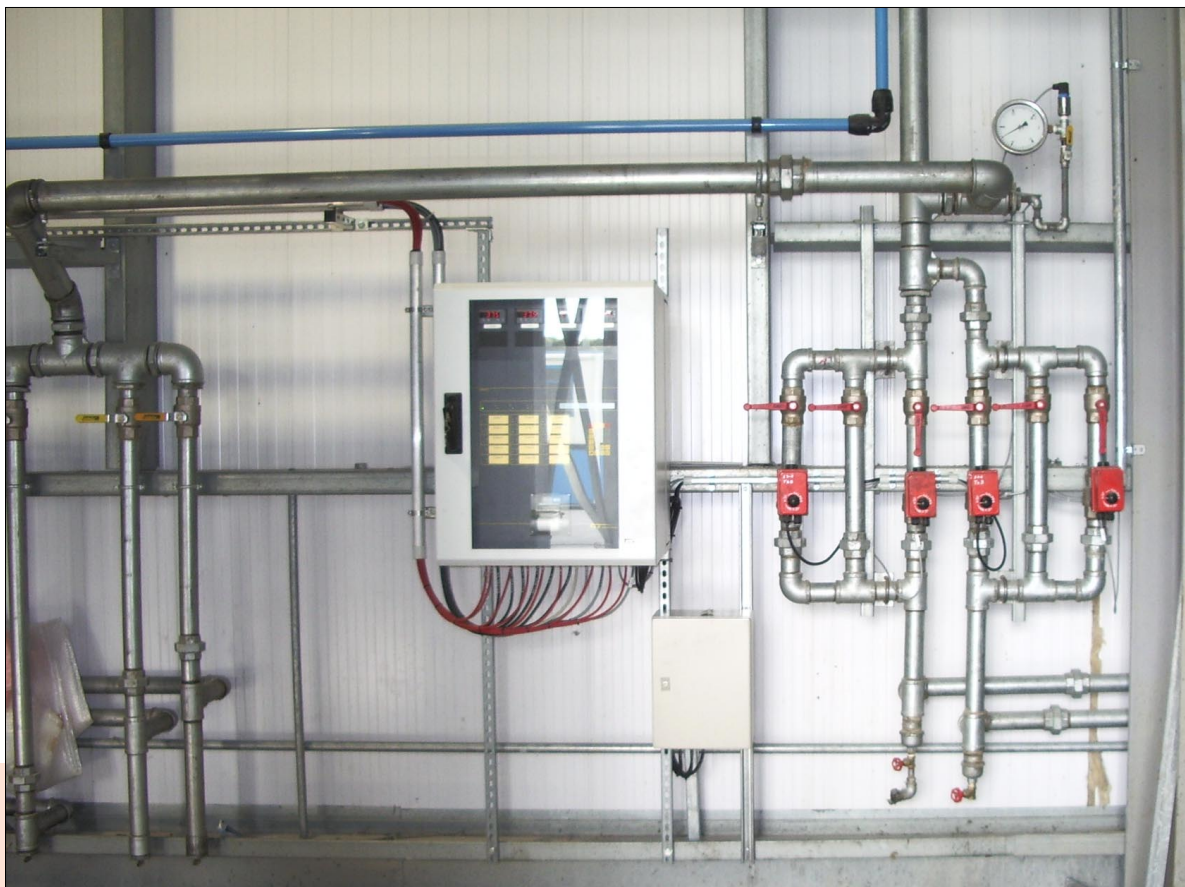
Abb. 3: Funkenmelde- zentrale und Wasserversor- gung der Fun- kenlöschanlage
